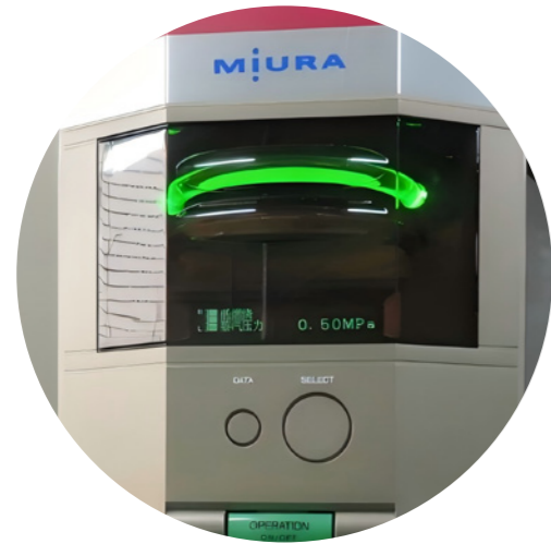
“P&T2 锅炉系统优化改造”项目
