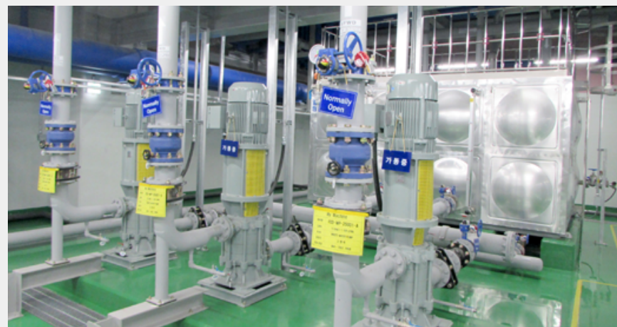
冷却塔排水再利用系统
