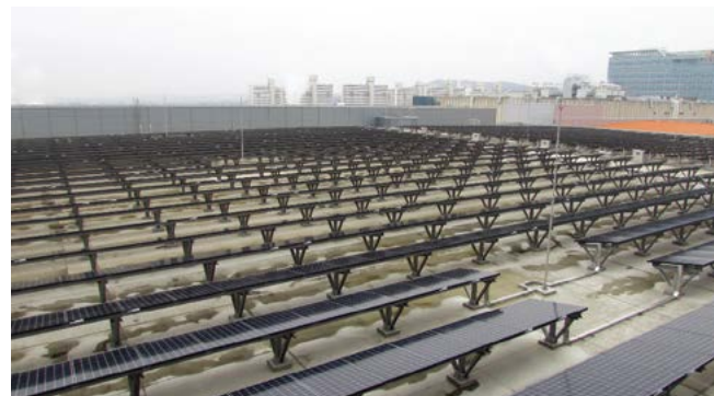
이천사업장 패키지&테스트 공장에 설치한 태양광 발전 설비
