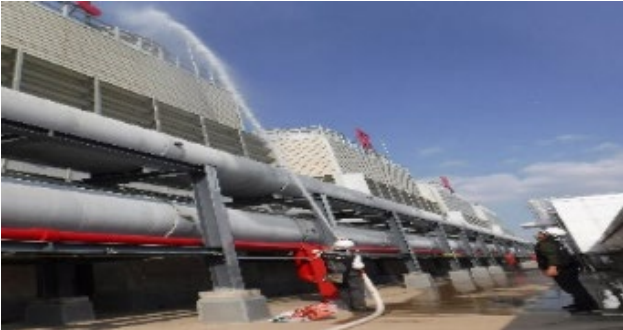
消防安全设备定期点检
